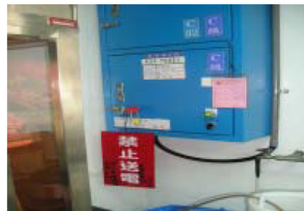
設備維修應斷電掛牌上鎖
